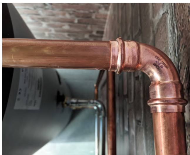
Bild 16 - aesPRES UNIKO - Heizung
